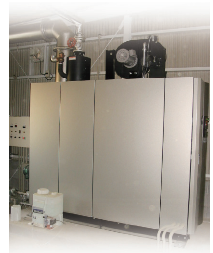
ガスボイラー
