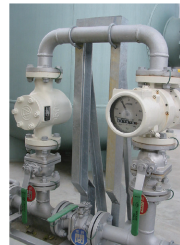
ガスメーター
