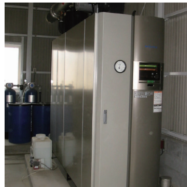
ガスボイラー
